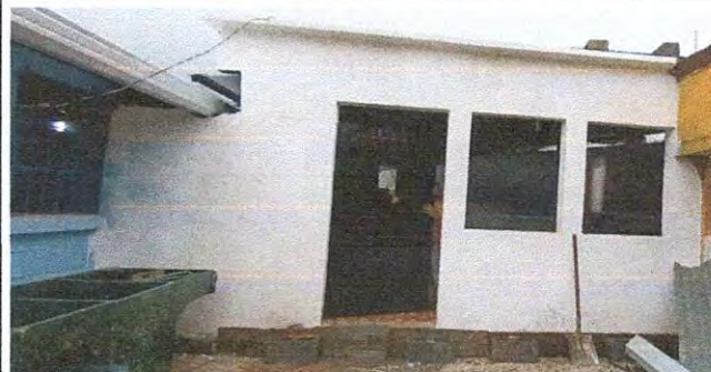
Foto 6: Sustitución de canales se encuentra en mal estado.
